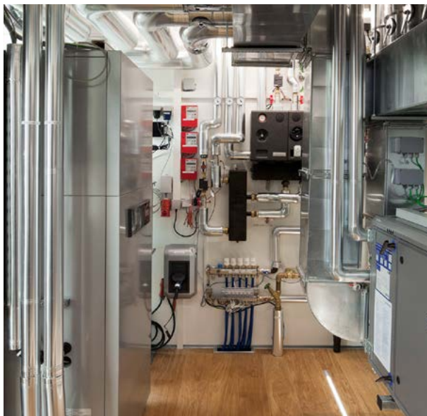
Blick in den Technikraum
