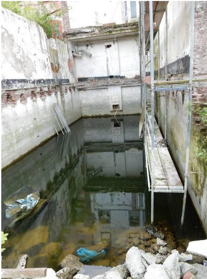
Mit Regenwasser vollgelaufenes Kellerfundament
