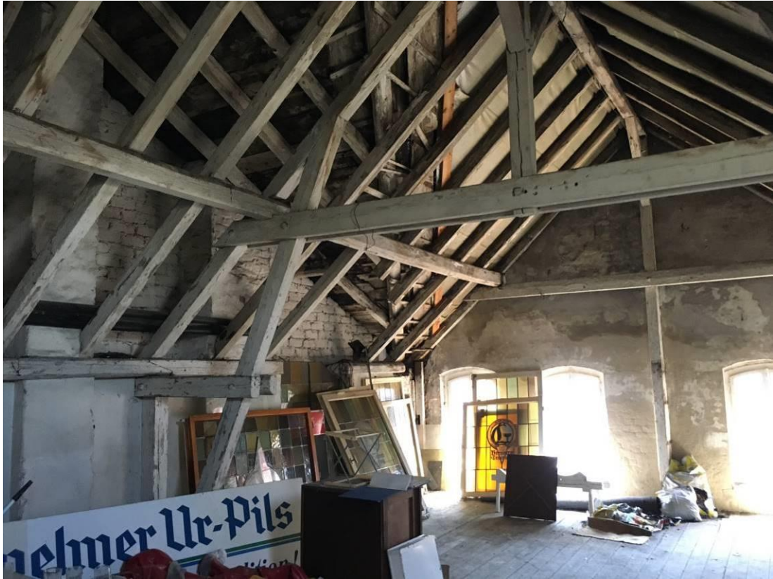
Die Dachräume des Hauptgebäudes sind trocken aber nicht wärmedämmend und für potenzielle Gebäudebesiedler von außen teilweise durch defekte Fenster zugänglich.
