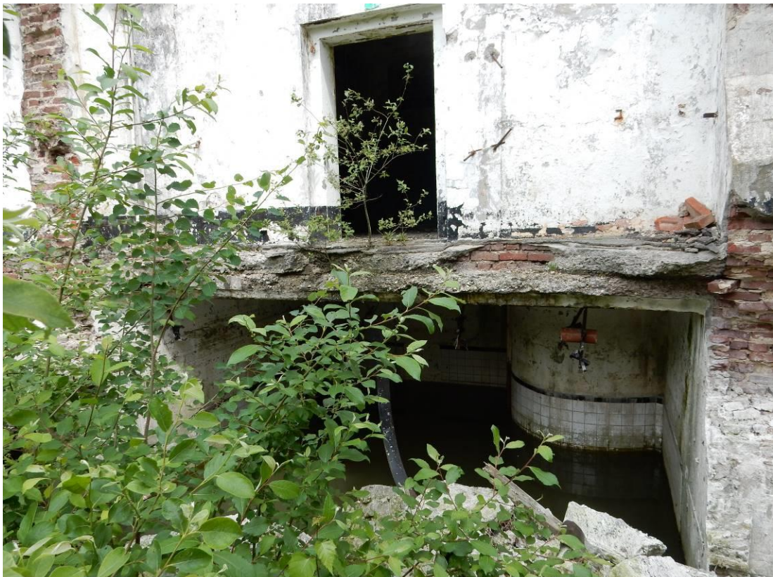
Durch die Abrissarbeiten sind teilweise offene Zugänge in die Kellerräume und das Erdgeschoss entstanden, die z.B. von Vögeln oder Fledermäusen als Einflugmöglichkeiten in das Gebäude genutzt werden können.
